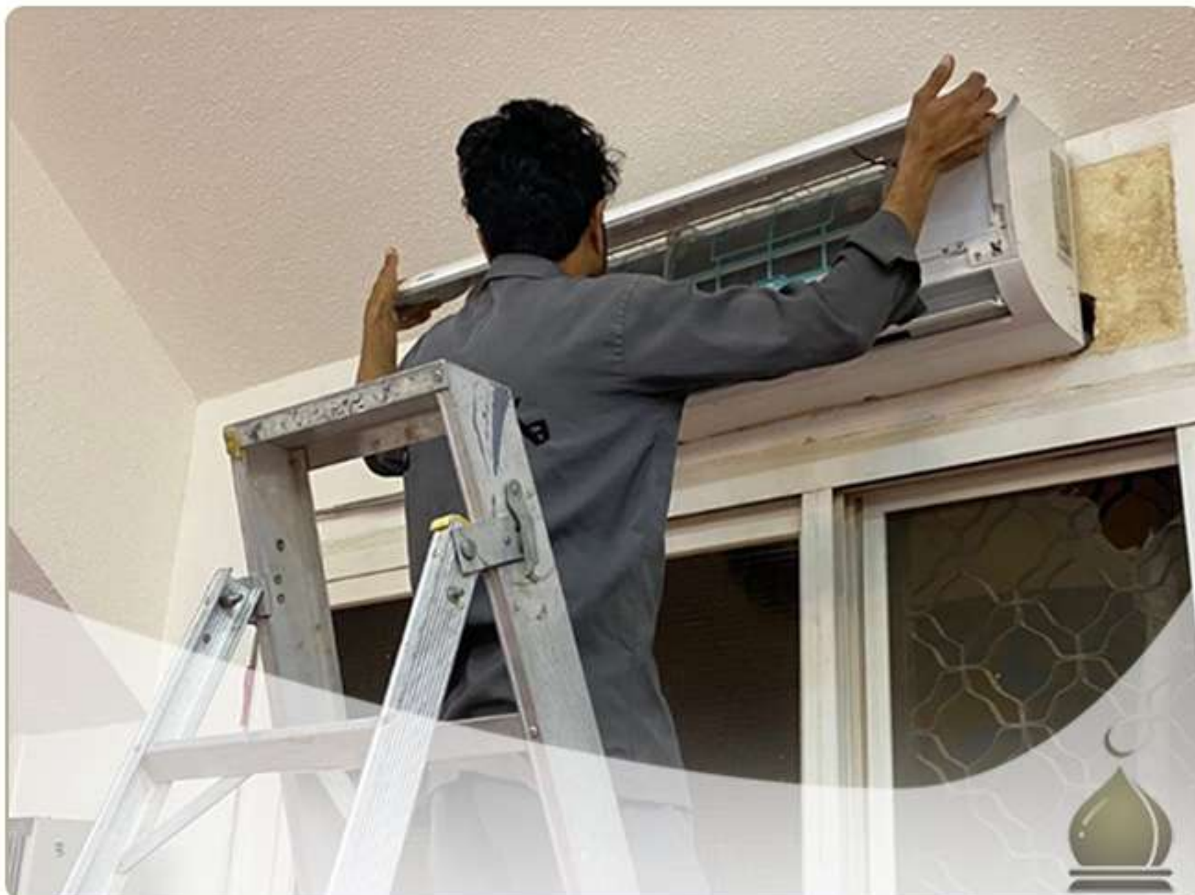
مسجد سلمان الفارسي صيانة 8 اسبليت صيانة الكهرباء
