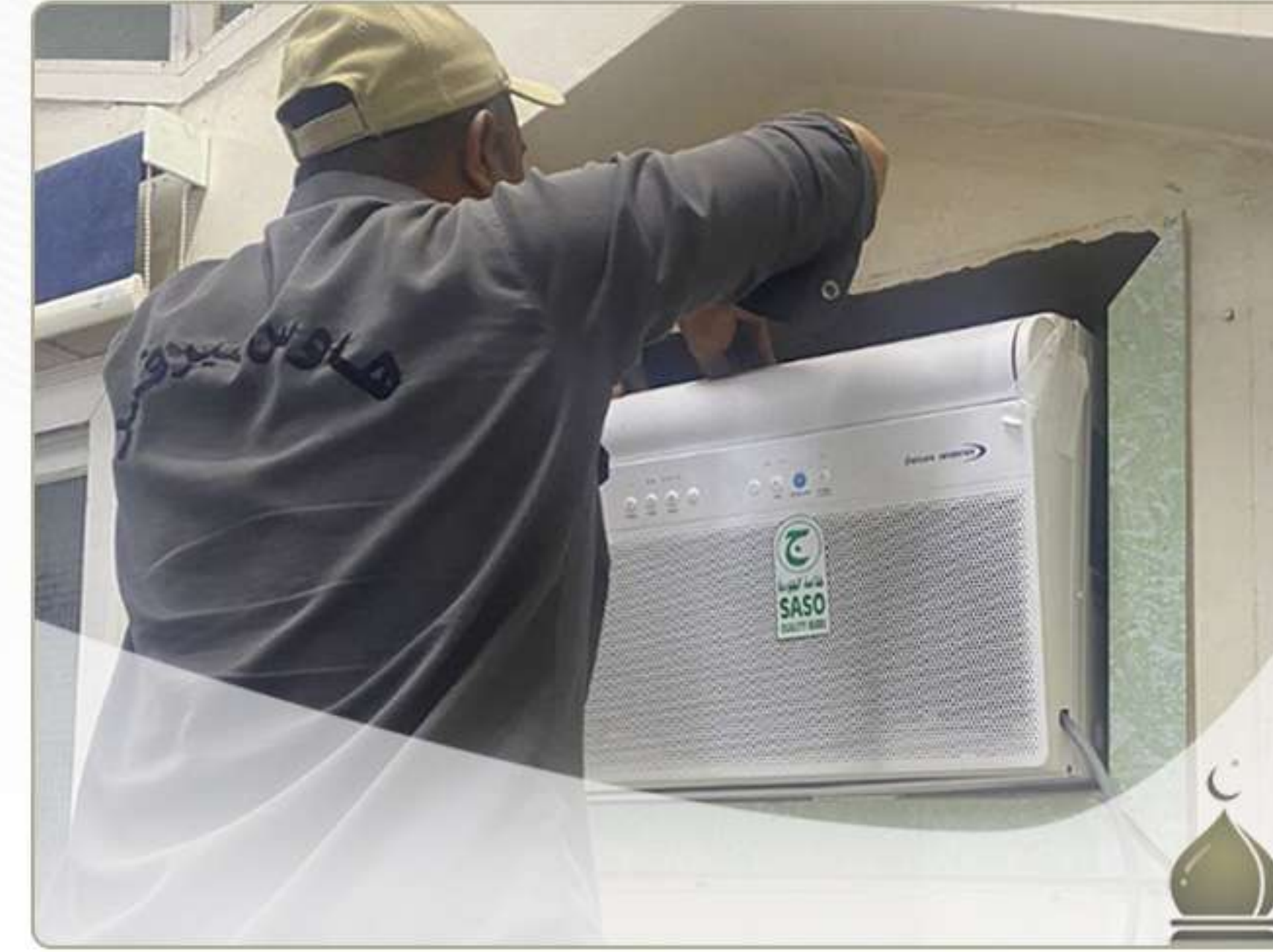
مسجد الضحاك بن الحارث تركيب 6 مكيفات جديدة
